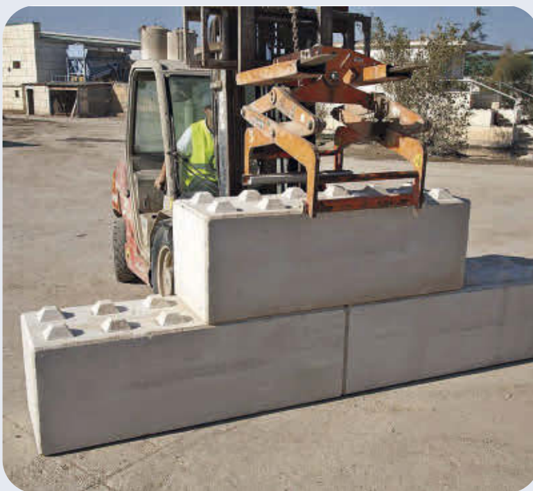
Una carretilla traslada varios bloques de Megalito, un material de construcción sostenible que Casalé creó hace ahora diez años.
